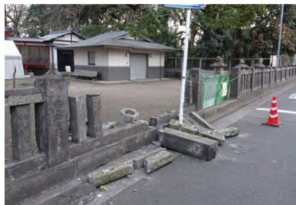
市道沿いの玉垣破損
