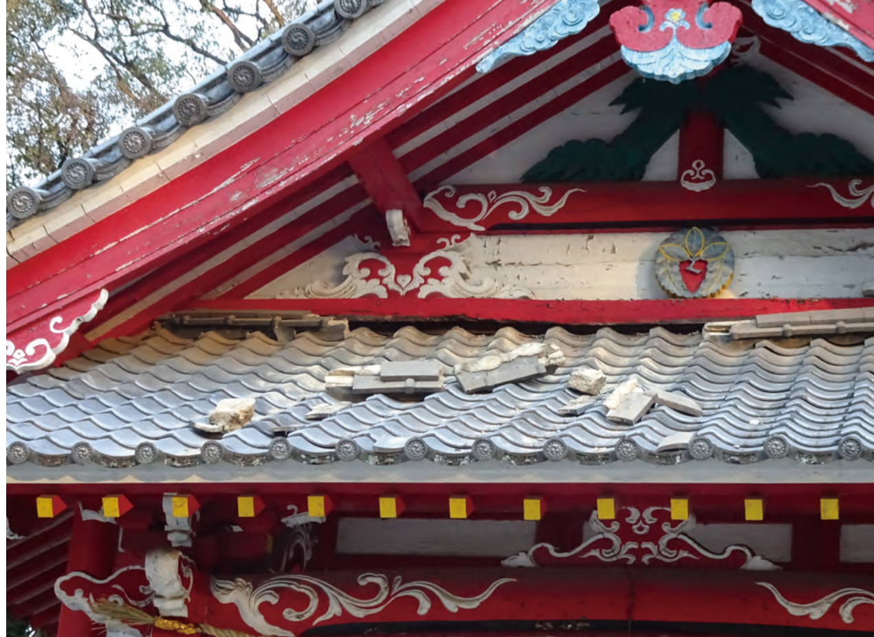
絵馬堂 屋根瓦破損
